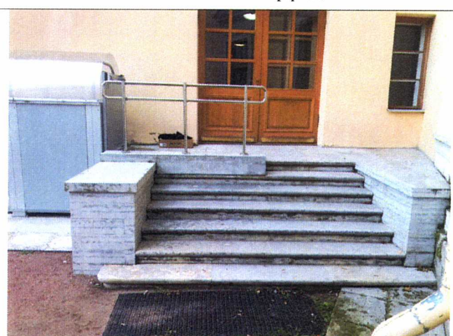
Фото №58– Запасной выход, оборудованный, подъемной платформой с вертикальным перемещением
