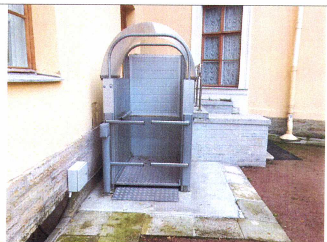
Фото №59– Запасной выход, оборудованный, подъемной платформой с вертикальным перемещением
